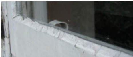
Stopverf met asbest valt in risicoklasse 2
