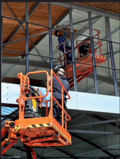
▲ Door de inzet van hoogwerkers kon alle schilderwerk op hoogte worden uitgevoerd.
